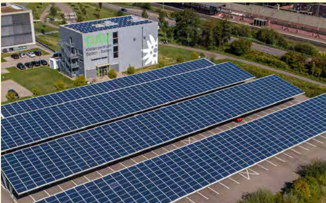
Park&Ride-Parkplatz der Stadtwerke Baden-Baden mit 371,3 kWp Photovoltaik
