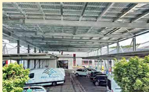
Solardach eines Waschparks in Tübingen
