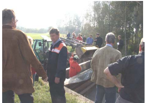
Schließen der Dammscharte am Rheinsträßel unter Beobachtung des Abnehmenden und Mitgliedern des Gemeinderates
